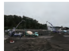
興部町のガス発電プラント
