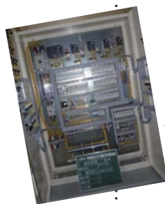
雄武町学校給食センター 建設工事（電気設備） 動力設備機械室 動力盤の取り付け状況
