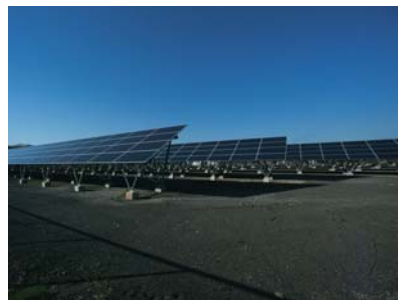
平成27年1月稼働予定の興部町太陽光発電所 パネル数290W×4,200枚
